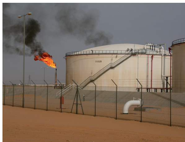
Figure 1 : Une torchère. Dans cette haute tour métallique sont brûlés des déchets de gaz. Source : CC-BY-SA-3.0, Javier Blas.
