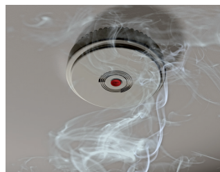
Figure 2 – Les capteurs de CO/CO 2 sont efficaces pour détecter les incendies sans fausse alerte.
